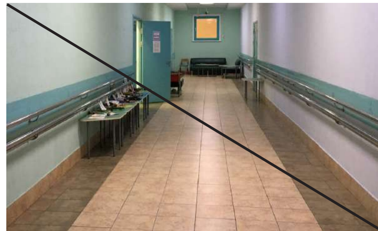
Плохо Керамогранитная плитка с крупными швами
